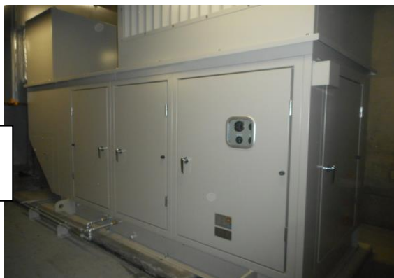
非常用発電機
