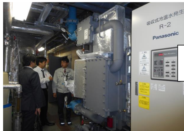
冷温水発生機
